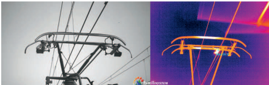
Confronto di un'immagine acquisita nel campo del visibile con una termografica per effettuare misurazioni di temperatura sul punto di contatto tra pantografo e linea aerea
